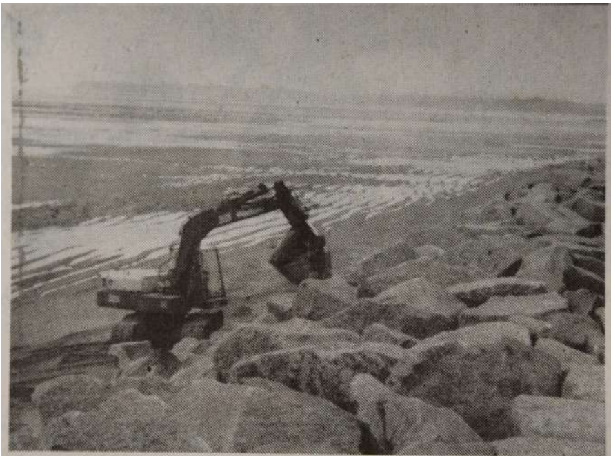
Entre chaque marée des entreprises remplacent les blocs de granit comme ici à Kairon.
