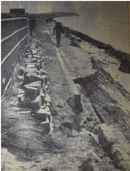
Sur trois cents mètres de longueur, le remblai-promenade de la Vogue-Blanche (piège de Kairon) a été réduit à néant. La mer a emporté quatre mètres de chaque côté des ouvrages de défense.
