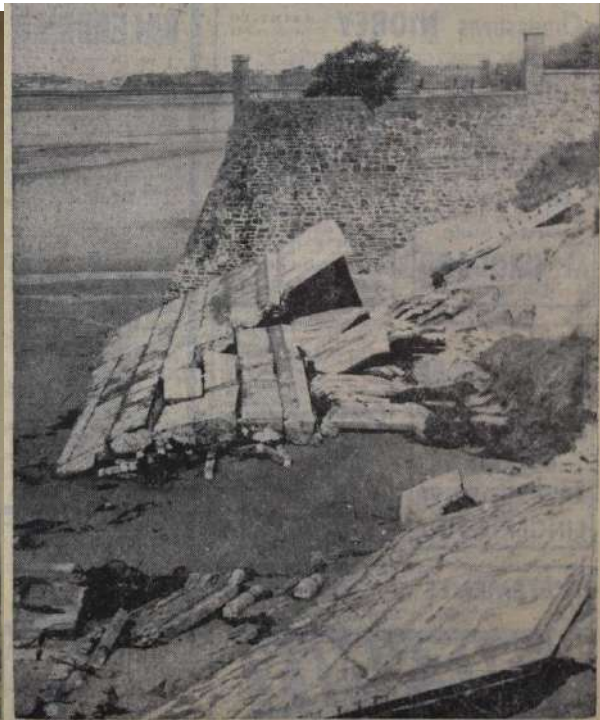
À Saint-Pair, le particulier (M. Berger) avait édifié un brise-lames d'un million de francs. L'ouvrage n'était terminé que depuis un mois. Il a sombré lui-même dans la tempête.
