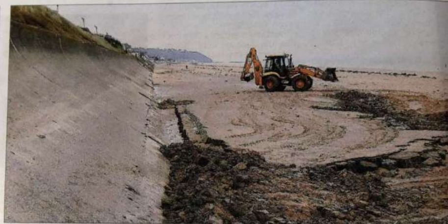
Les pieux en bois constituant la base de la digue nord sont à découvert. Les Services Techniques tentent de boucher les trous avec la tangue prise sur la plage à l'aide d'un tractopelle.
