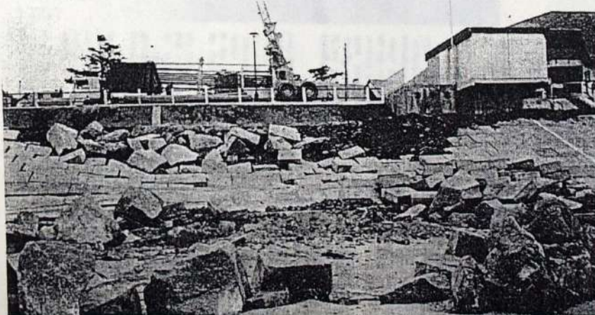
La digue après la tempête.
